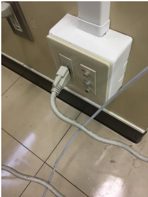
壁面接続端子
